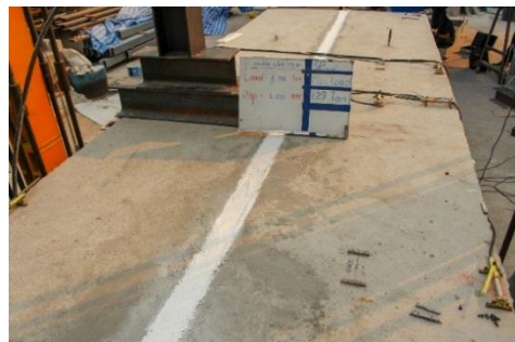
รูปที่ 13 ภาพการทดสอบชิ้นส่วนสะพานสำเร็จรูปคู่แบบสถิติศาสตร์ เพื่อพิจารณารอยแตกร้าวระหว่างแผ่น
